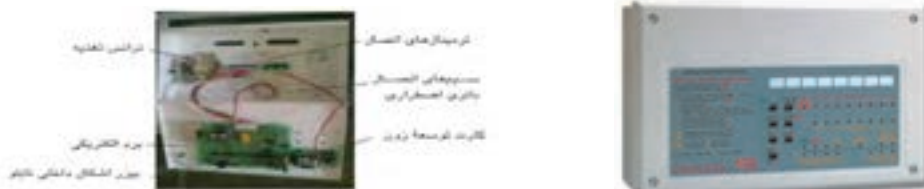
شکل ۱۷- اجزای داخلی تابلوی اصلی
